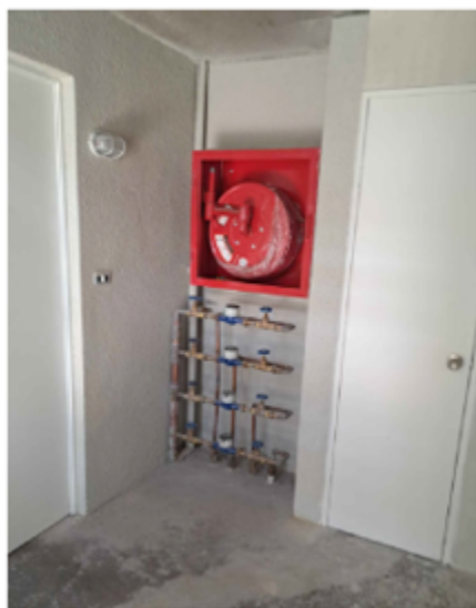
SITUACION ACTUAL NICHOS MEDIDORES
