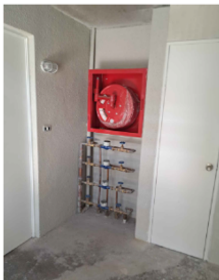
SITUACION ACTUAL NICHOS MEDIDORES
