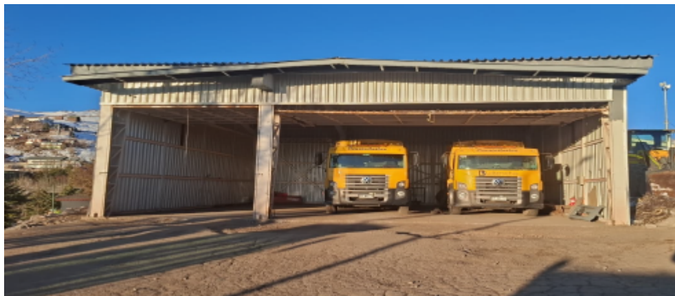
Imagen N°3: Galpón camiones, 02 hojas de 4m de alto, 01 hoja de 3.6m de ancho y la otra hoja de 7.4m de ancho
