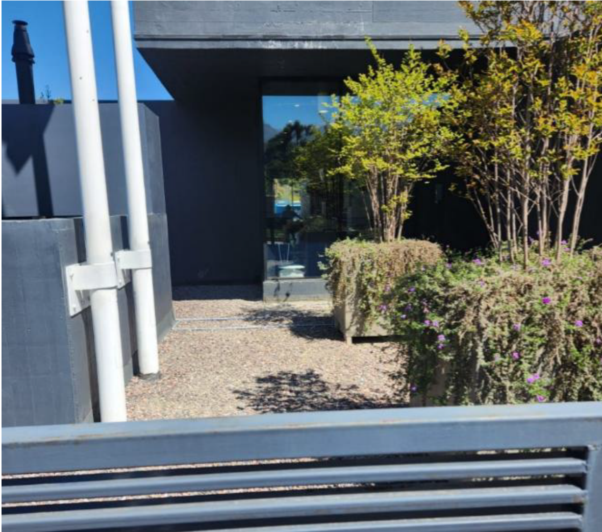
Imagen: ubicación de bombas de calor
